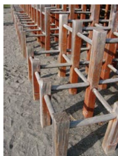
写真5 柱頭木口の劣化
