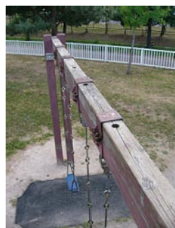
写真6 水平部材の劣化
