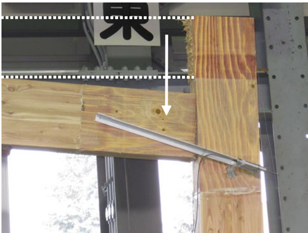
写真4 梁の曲げ破壊後の様子
