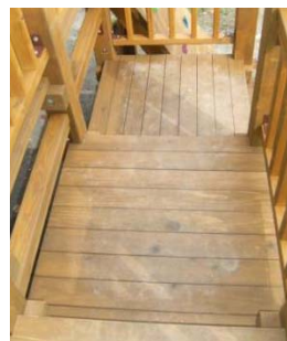
写真3: 釘の露出しない床
