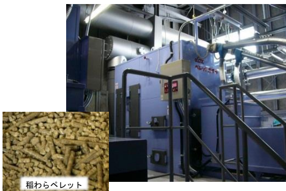
図1 南幌町のペレットボイラー
