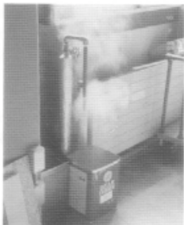
写真1 工場内での蒸気噴霧
