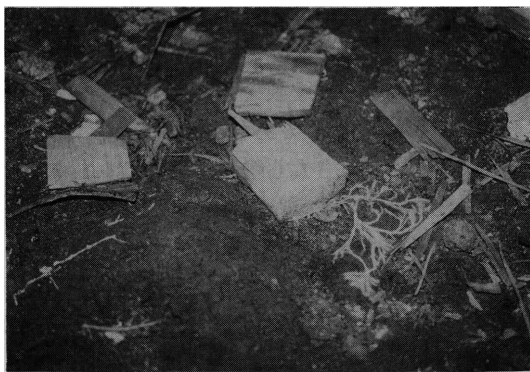
写真1 床下の建築残材から生長した菌糸
