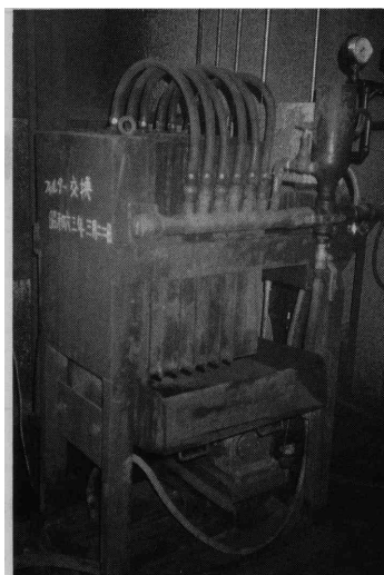
写真2 脱水機(フィルタープレス)
