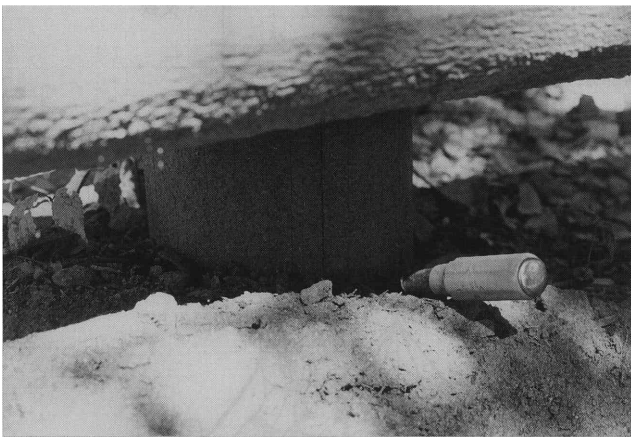
写真1 地盤部の腐朽
