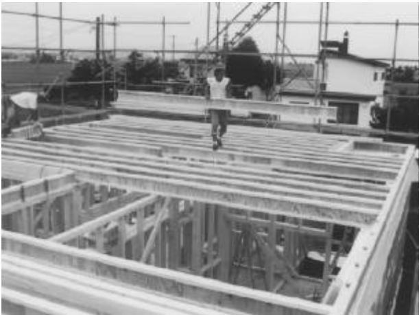
第14図 A邸の2F床組 Fig. 14. Framing the second floor of A's housing.
