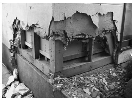
第3図 露出した土台
