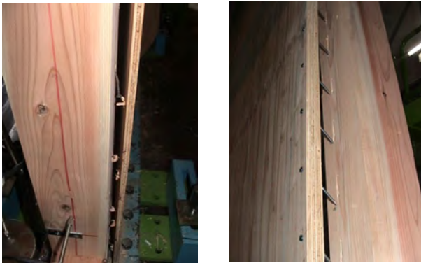
(a) 釘頭の貫通 (b) 釘の引き抜け 図2-2-3-6 道産構造用合板の厚さの違いに起因する耐力壁の破壊形態の違い
