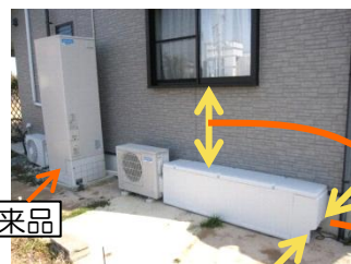
住宅外部への設置状況
