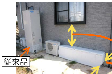
住宅外部への設置状況
