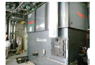
バイオマスボイラー
