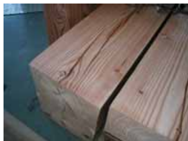
中温(100℃未満)条件 材面割れが発生
