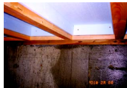
木造住宅床下の高湿度状態
