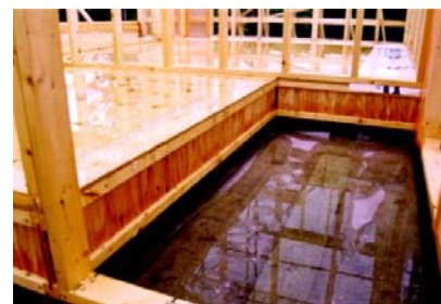
施工中の雨水による水濡れ
