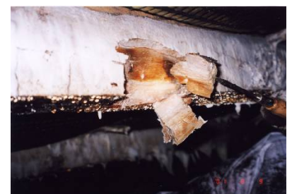
腐朽した木材
