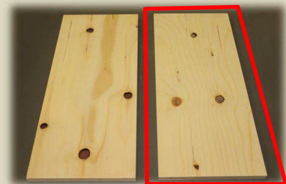
節が脱落した合板
