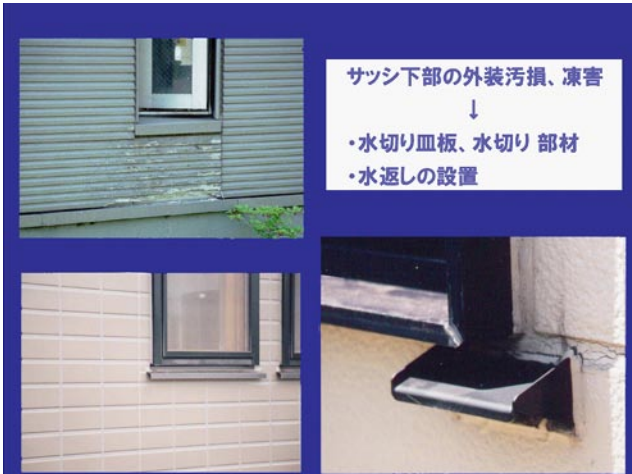
図17 サッシの外側周辺部の傷害
