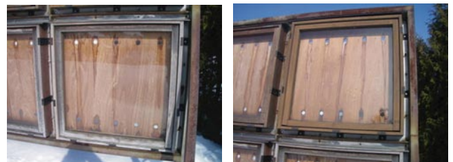
写真2 木製サッシの暴露試験 (浸透タイプ南面 15年目) 左：取付後再塗装無し 右：再塗装有り
