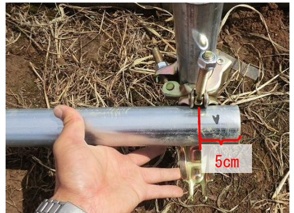
写真 5-2-1 妻面の単管のはみ出し
