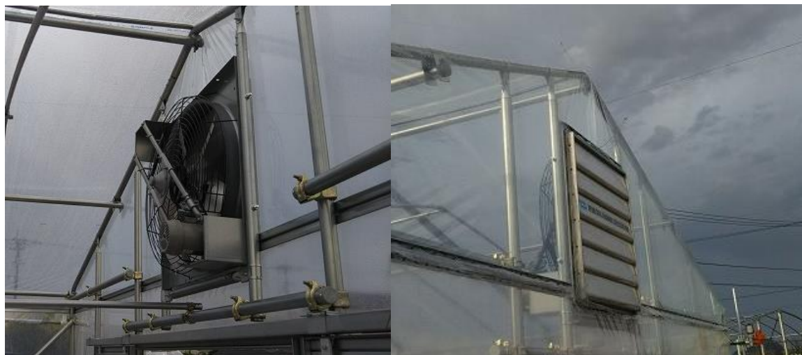
写真 7-2 換気扇の設置例 (農研機構 西日本農業研究センター)
