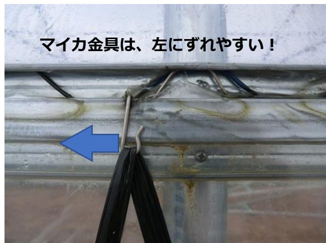
写真 7-9 マイカのずれによる PO フィルムの破損
