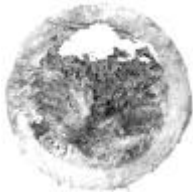
図1 暗きょ管の閉塞状況
