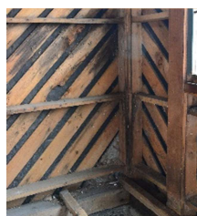
(b) A 棟劣化調査
