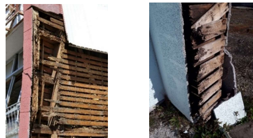
(a) 柱の腐朽と虫害 (b) 木摺りの腐朽
