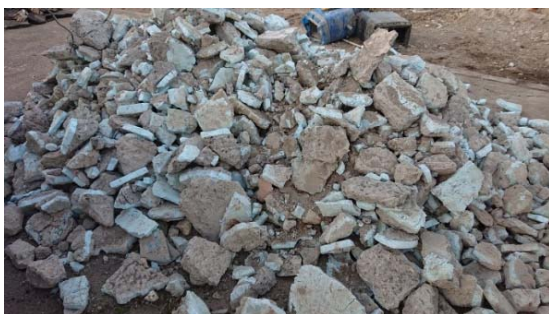
コンクリートが付着した押出法ポリスチレンフォーム
