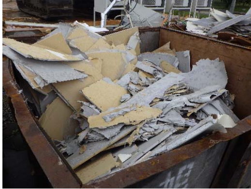
写真 2-8 石膏ボードをゴミ箱に入れたところ (B)
