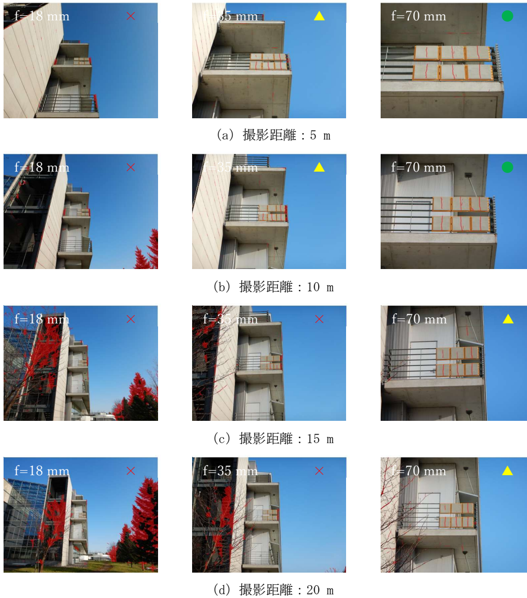
図 3-8 ひび割れ検出結果 (試験体設置位置 3 階, コンパクトデジタルカメラ使用)
