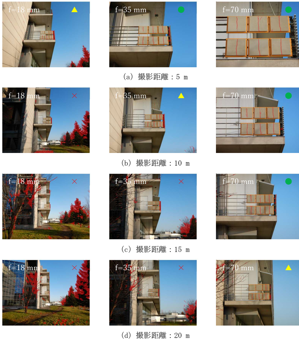
図 3-7 ひび割れ検出結果 (試験体設置位置 2 階, コンパクトデジタルカメラ使用)
