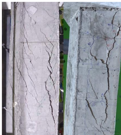
図 6-1 (左)螺旋状のひび割れと (右)コーナースプリット型亀裂
