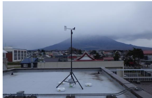
写真 2-5 風向風速計の設置状況
