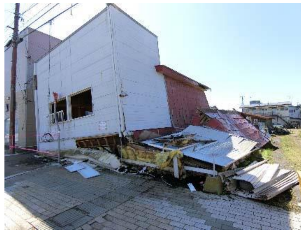
写真1 店舗併用住宅被害
