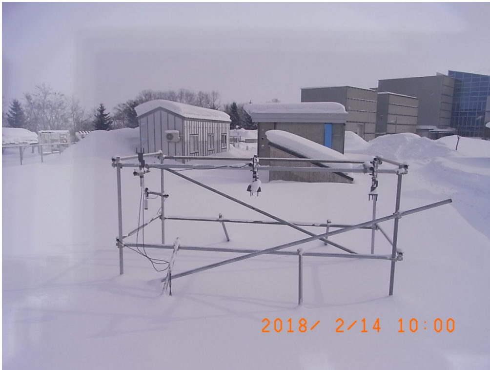
写真 13 2018/2/14 における風向風速計の着雪状況
