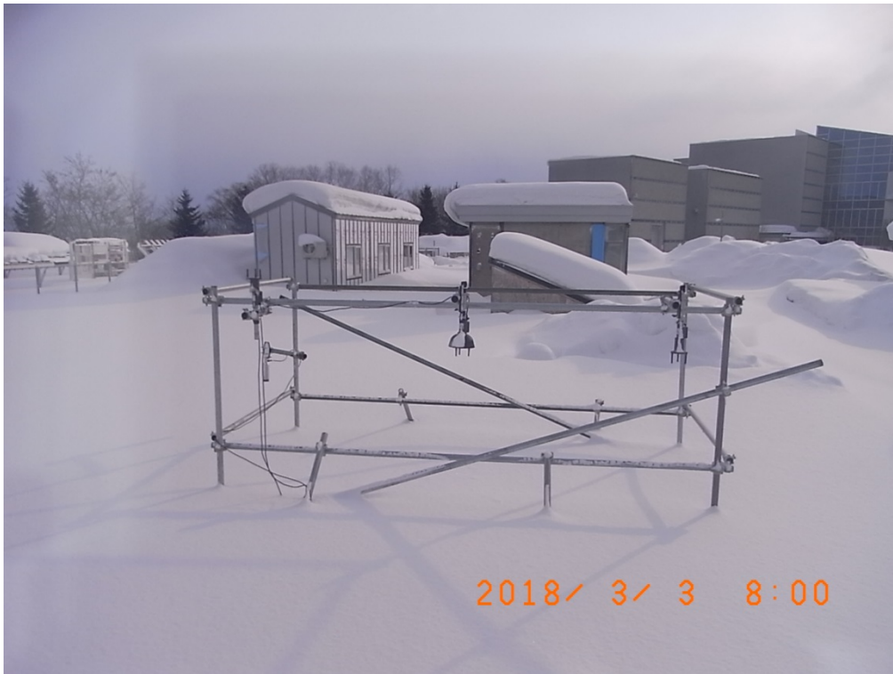
写真 19 2018/3/3 における風向風速計の着雪状況
