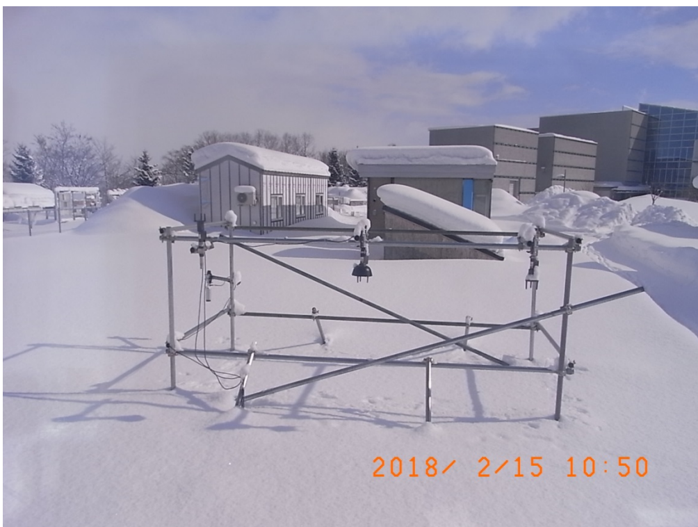
写真 16 2018/2/11 における風向風速計の着雪状況
