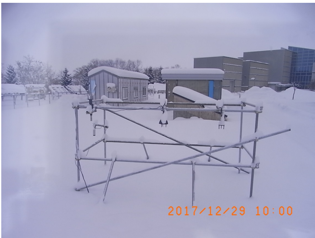
写真4 2017/12/29における風向風速計の着雪状況
