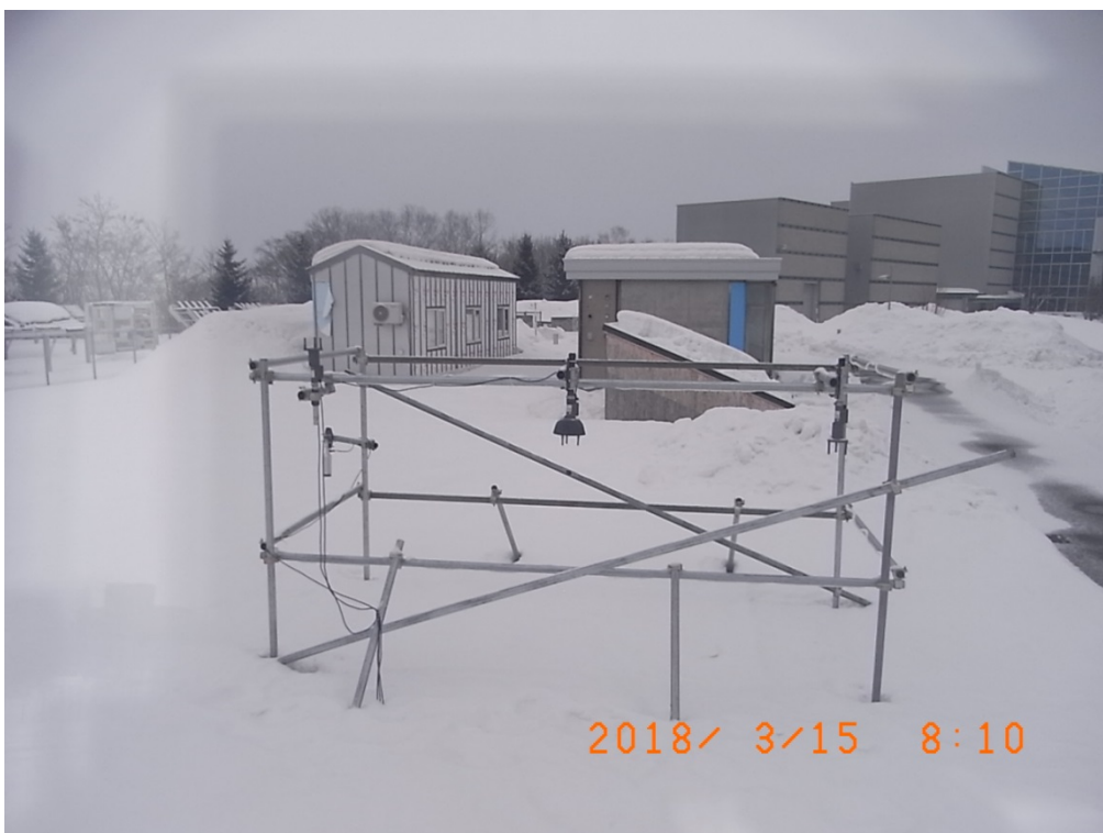
写真 22 2018/3/15 における風向風速計の着雪状況
