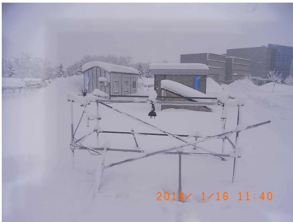
写真9 2018/1/16における風向風速計の着雪状況
