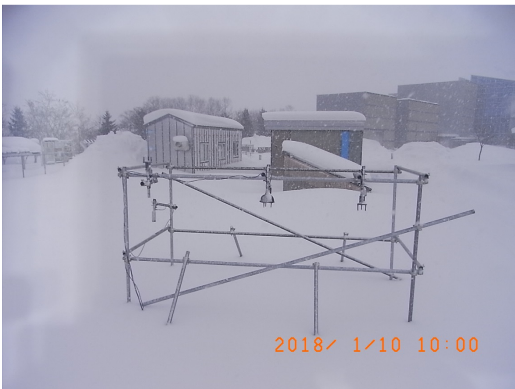
写真6 2018/1/10における風向風速計の着雪状況
