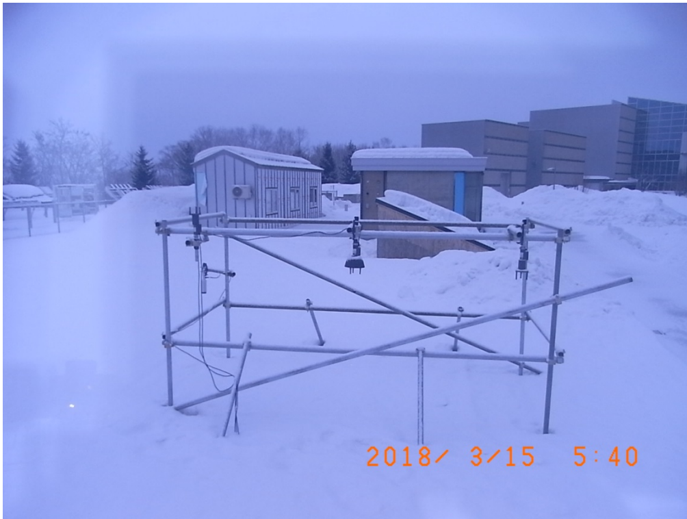
写真 21 2018/3/15 における風向風速計の着雪状況
