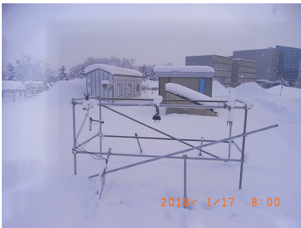
写真10 2018/1/17における風向風速計の着雪状況
