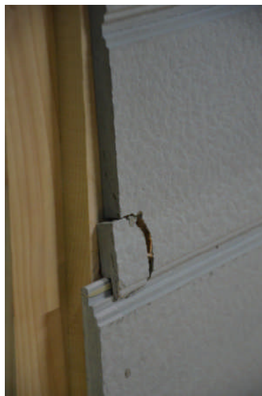
サイディングの割れ
