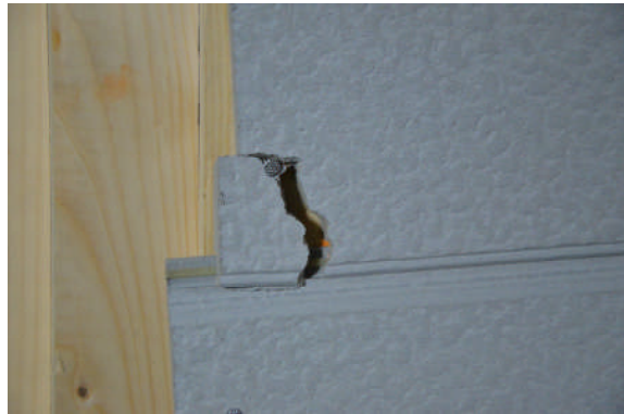
サイディングの割れ
