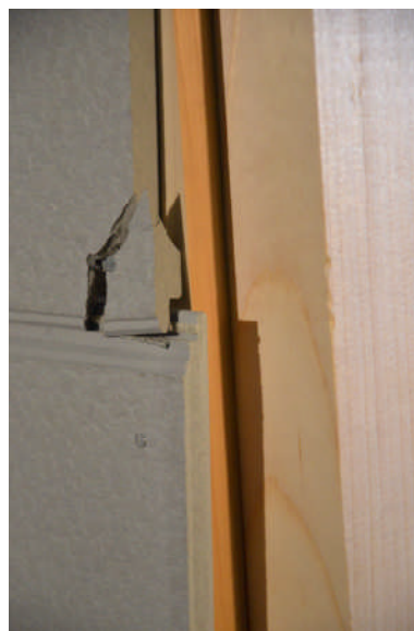
サイディングの割れ
