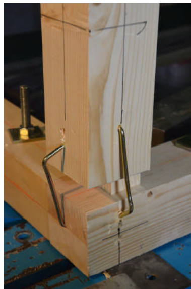
かすがいの引き抜け
