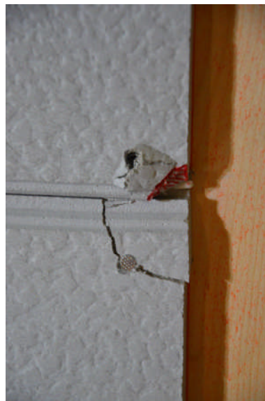
サイディングの割れ
