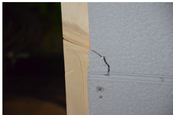
サイディングの割れ
