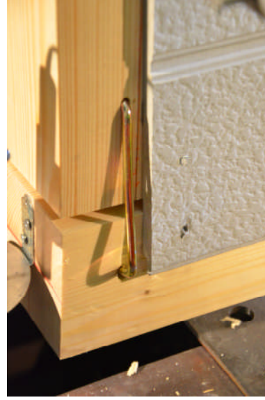
直交壁端柱脚の引き抜き
