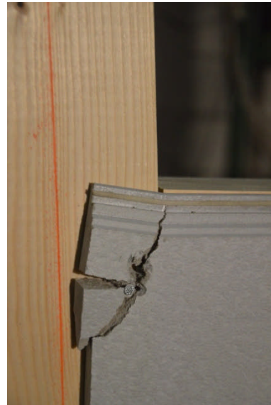
サイディングの割れ
