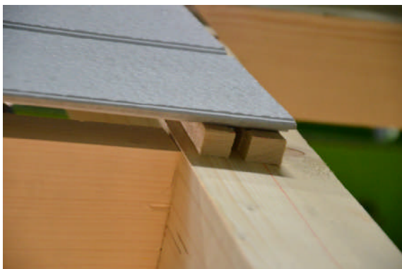
通気胴縁の割れ
