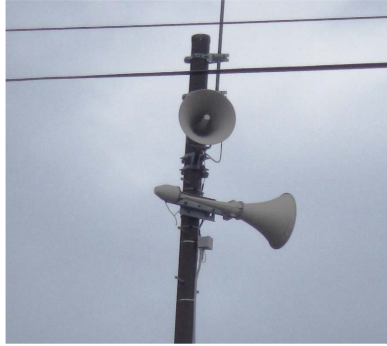
写真1 防災スピーカー
