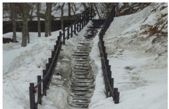
図 5-4 凍結により滑りやすい避難階段
