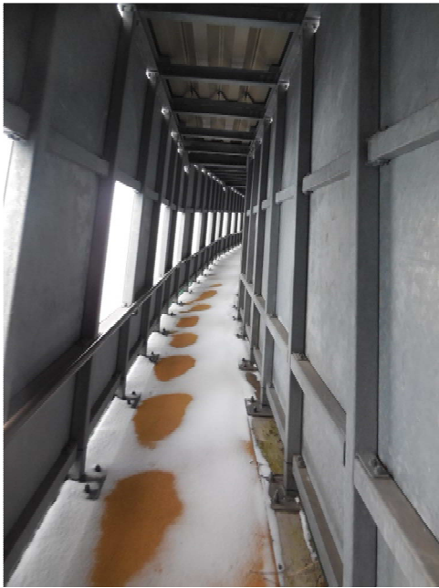
図 5-5 雪の吹き込みにより滑りやすい避難経路
