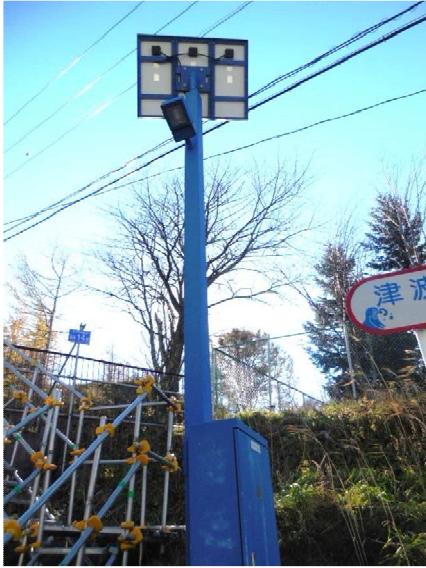
図 5-7 太陽光発電による照明
