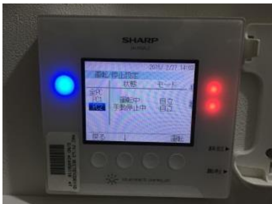
図 8-3 太陽光発電操作パネル
