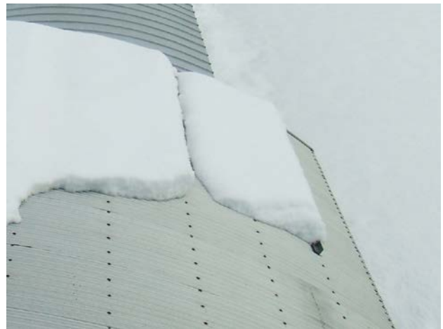
写真 5-28 雪止めの設置例
