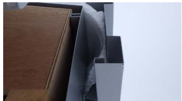
写真 5-25 雪止め空隙に雪が入り込んでいる状況
