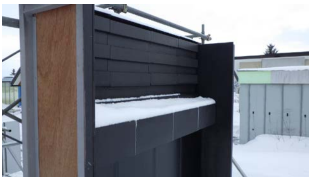
写真 5-16 PC 小庇の着雪状況 (3/13/9：00)
