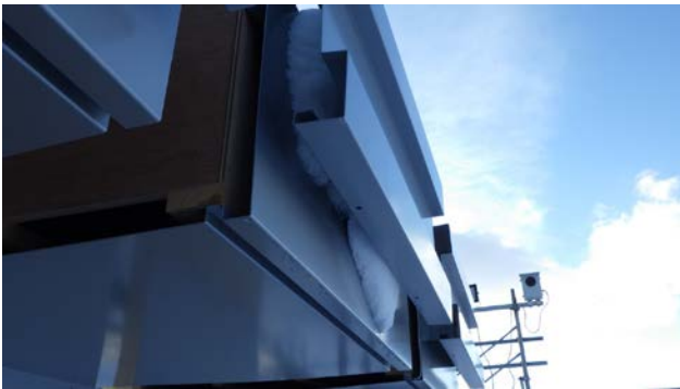
写真 5-27 雪止めの空隙から落雪する状況
