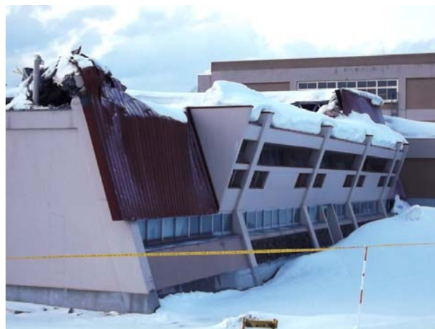
写真 1-1 屋根雪荷重で倒壊した体育館
