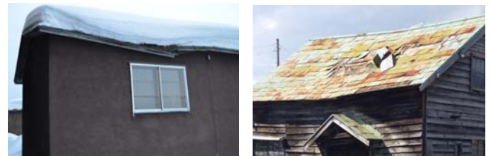
軒折れ 屋根葺き材の剥離
