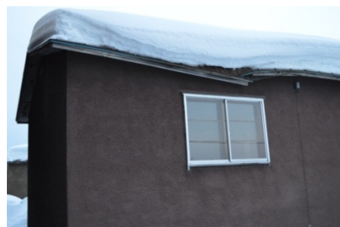
写真2-1 軒折れの被害例（旭川市）
