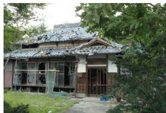
(b)屋根葺き材の剥離・飛散例
