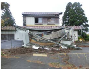
(a)雪荷重による軒折れ被害
