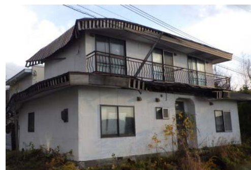
写真2-2 軒折れの被害例（鷹栖町）
