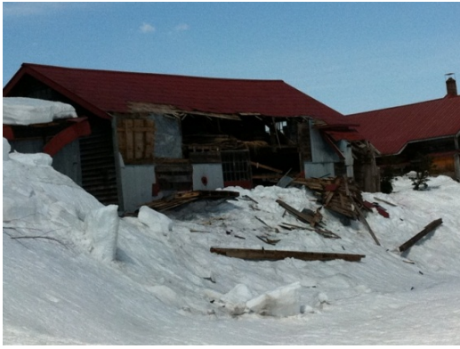
写真 2-3 小屋組の被害例（幌加内町）
