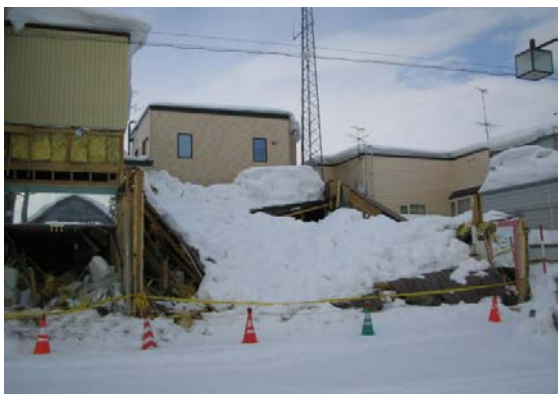
写真 1-1 雪荷重による空き家の倒壊例
