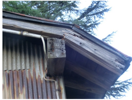
写真 4-2 劣化した軒垂木の損傷
