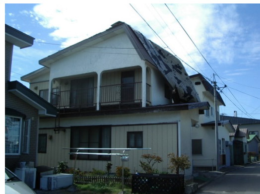
写真 2-4 屋根葺き材の被害例
