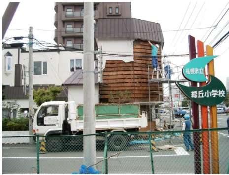
写真 2-6 壁面の被害例
