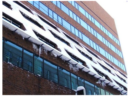
写真1-2 人力や設備による対応が困難な例
