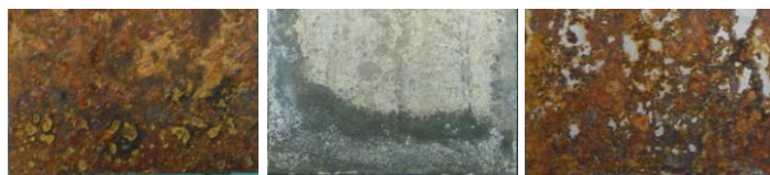
Zn 鋼板(308 サイクル) GL 鋼板(1148 サイクル) SD 鋼板(588 サイクル) 写真1 塩乾湿複合サイクル試験における無塗装鋼板の腐食状況
