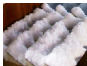
写真3 庇上の堆積状況
