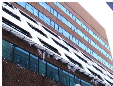
写真1 外壁における積雪と氷柱の発生
