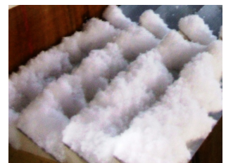
写真2 庇上の堆積状況
