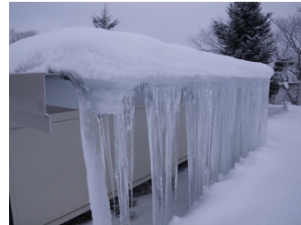
写真1 実験建物の氷柱と氷堤
