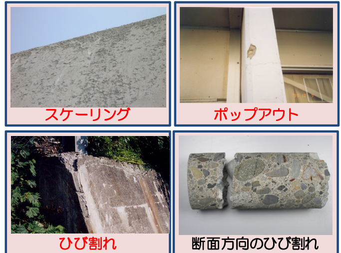
図1 コンクリートの劣化事例 (赤字は典型的な凍害によるもの)
