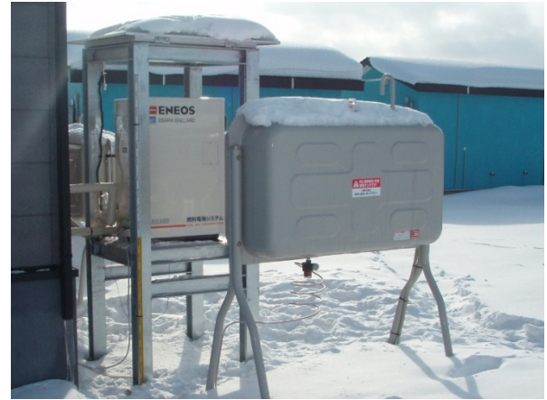
写真1 屋外設置の燃料電池
