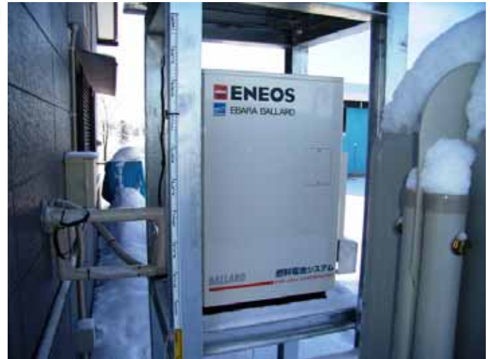
写真 1 屋外設置の燃料電池
