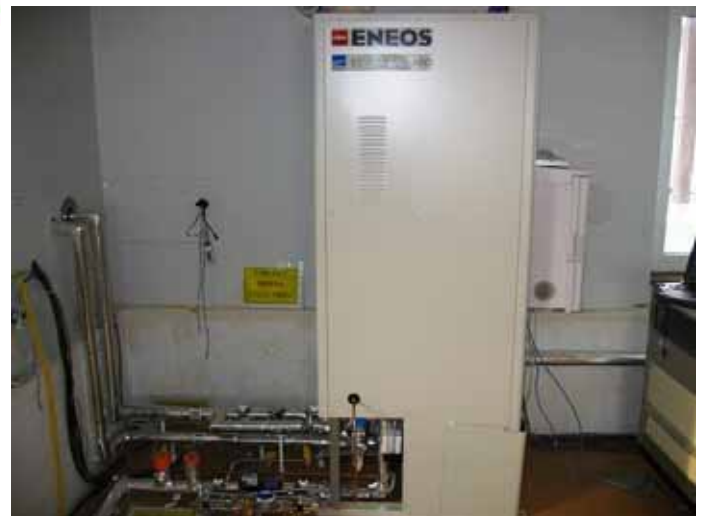
写真 2 屋内設置の貯湯槽
