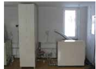
図 2 設置した燃料電池システム
