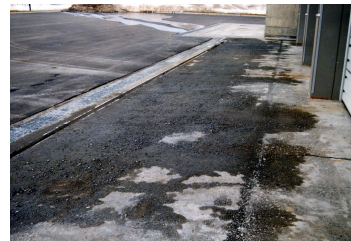
融雪剤による塩分と凍結融解による複合劣化を受けた土間コンクリート
