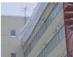
写真2 雪庇の形成状況
