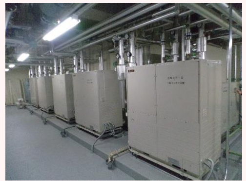
地中熱ヒートポンプ
