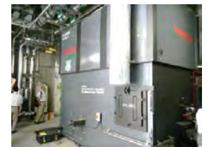
バイオマスボイラー
