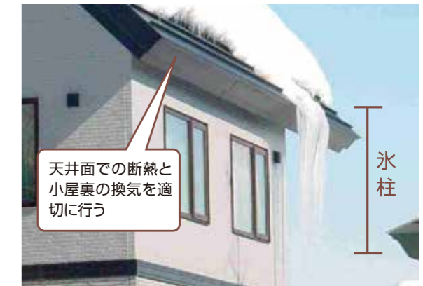
■写真:5 断熱と換気不足による氷柱の発生
