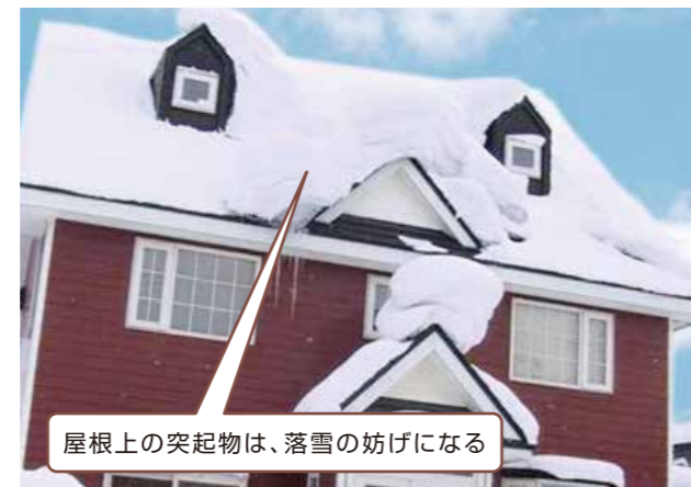
■写真:2 複雑な屋根形状での落雪障害
